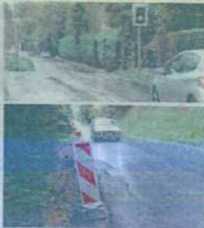
La RD513, une chaussée totalement effondrée et déformée, qui nécessite des travaux importants de reconstruction, mais aussi et surtout, une signalisation parfaite car il est préférable au respect.
