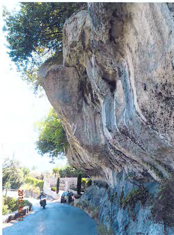
Photo n°21 : écaille instable après le pont de la D2210 à la sortie du village côté ouest
