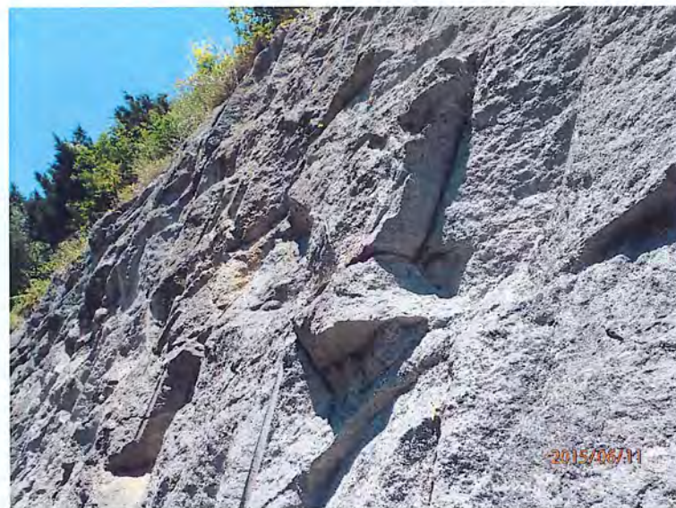
Photo n°23 : écaille instable avant le pont de la D2210 à la sortie du village côté ouest
