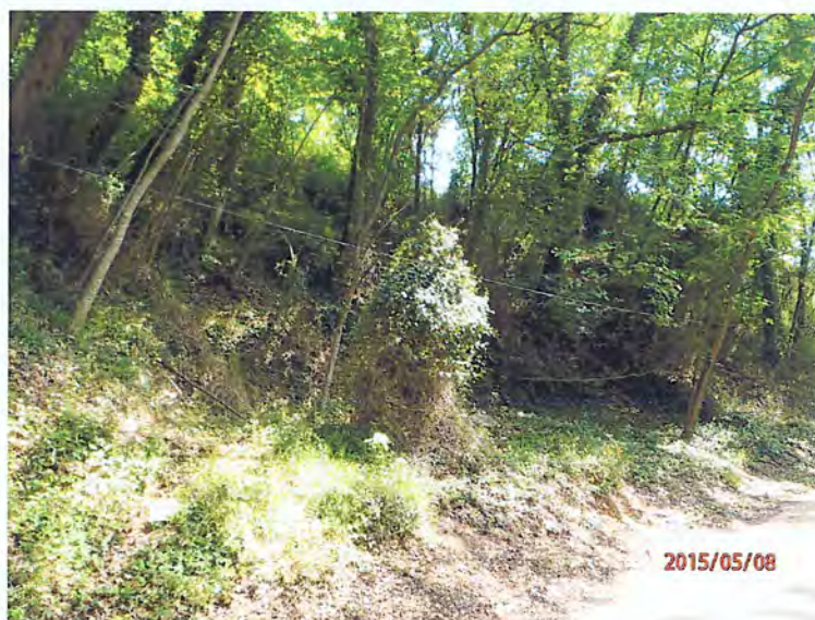
Photo n°13 : Route des Valettes (piste près du tunnel) Loupe de glissement
