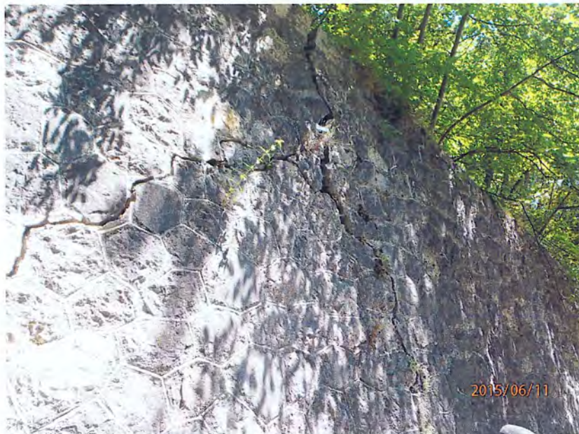
Photo n°15 : soutènement amont avant le tunnel du Pont du Loup Poussée des brèches de pente
