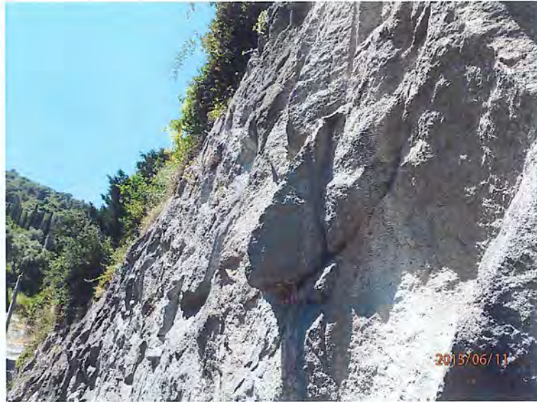
Photo n° 22 : écaille instable avant le pont de la D2210 à la sortie du village côté ouest
