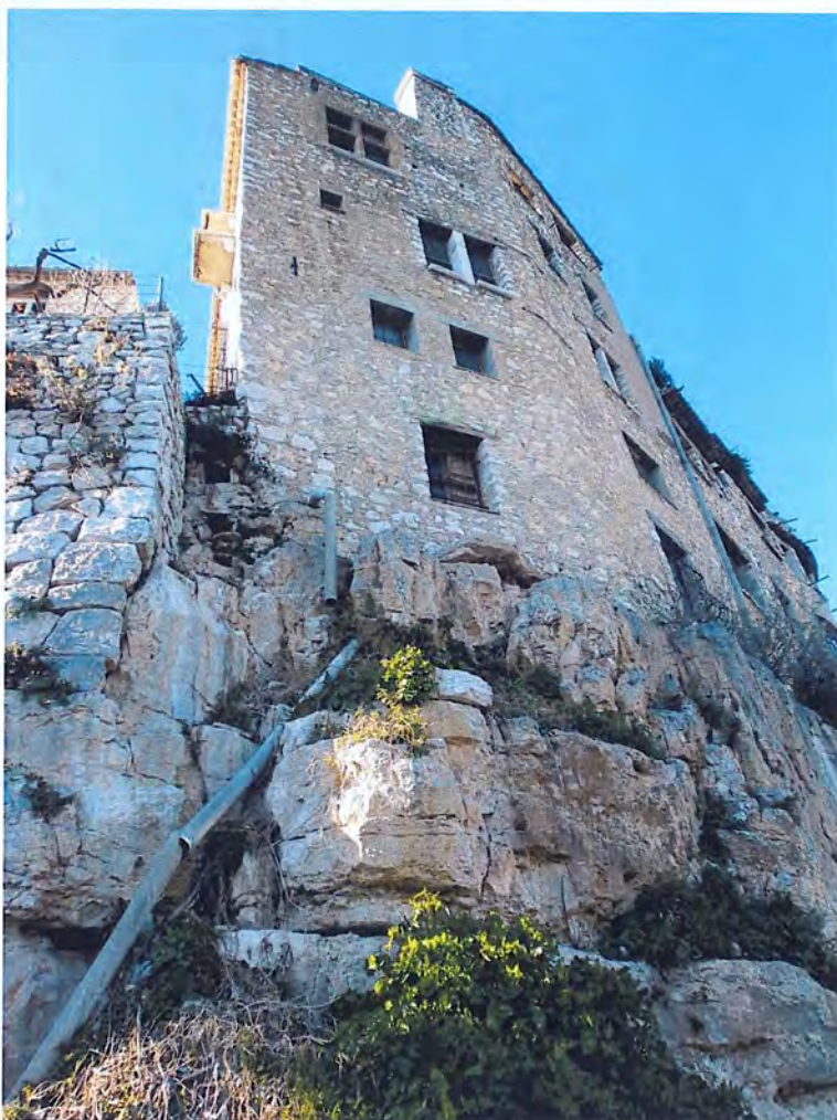
Photo n°27 : immeuble ancien reposant sur des bancs fracturés Écoulements d'eau usée défectueux
