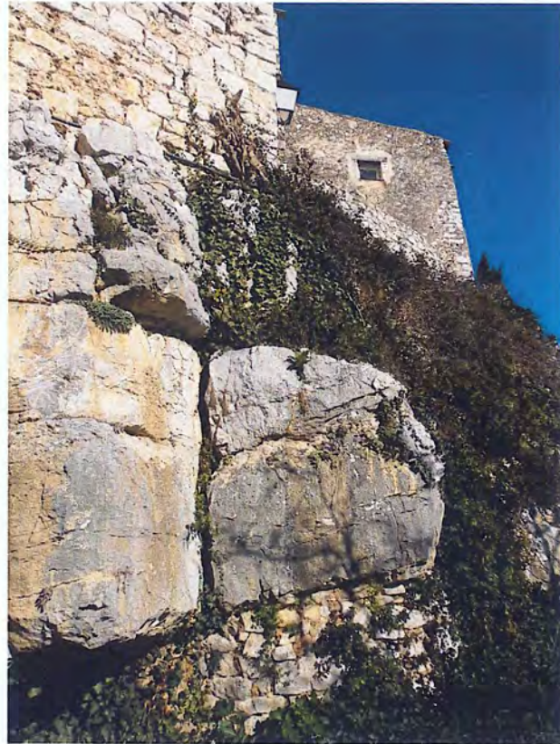
Photo n°34 : construction sur bloc instable
