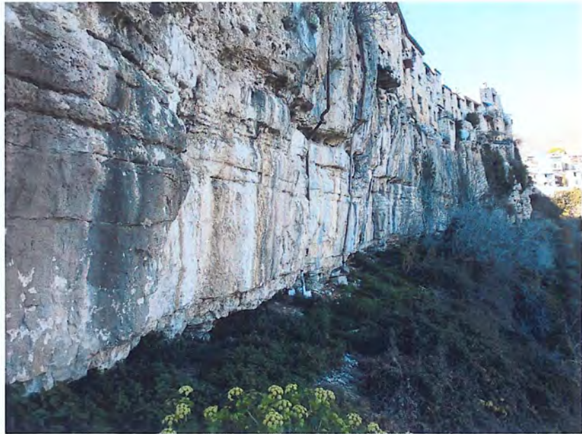
Photo n°28 : bordure de la falaise en encorbellements successifs Descentes d'eau à vérifier
