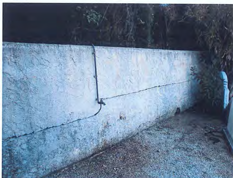
Photo n°16 : mur sud-ouest du cimetière
