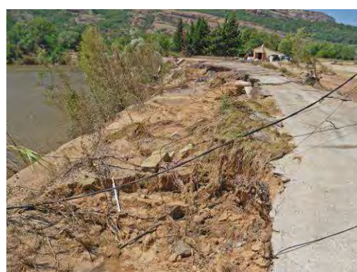
Photos 25 : L'Argens à Roquebrune Dégradation de la chaussée à l'amont du lac de l'Aréna - Post crue
