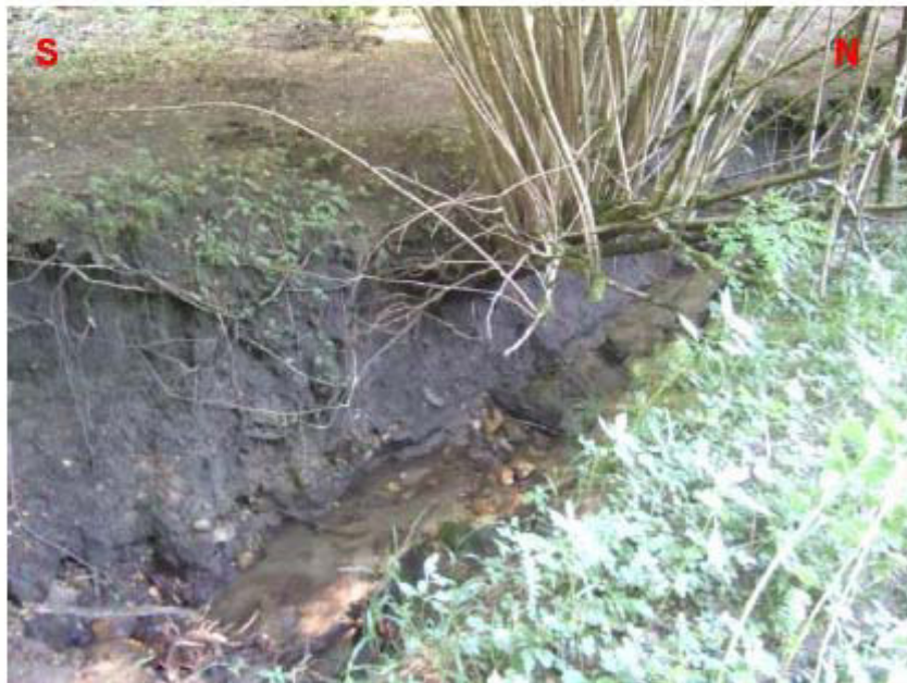
Figure 21. Erosion de berge d'un ruisseau très érosif: le ruisseau de la Tuilerie, en rive droite du Salat. L'affouillement y est tellement fort que le ruisseau creuse sous les racines des arbres en bordure.
