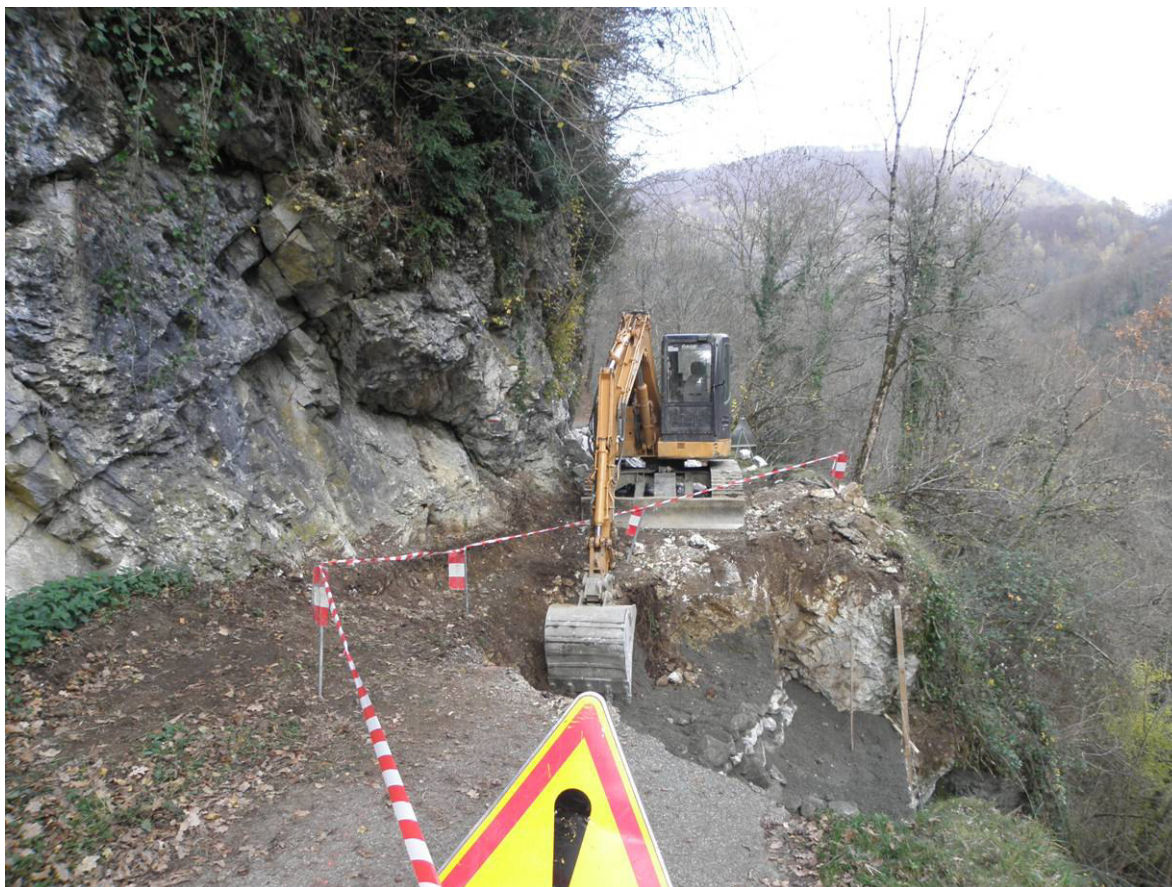
19/11/2009 : Route d'Esbints (RD 817) - PR 3+100; Effondrement de la route (rupture mur de soutènement). Clichés Jacques BLANC - Service RTM09-31
