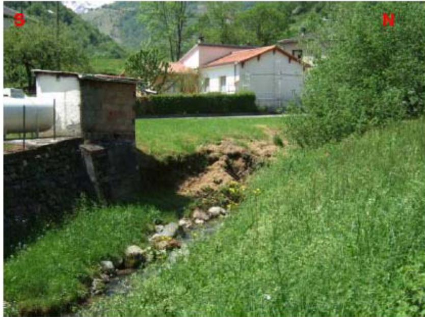
Figure 20. Erosion de berge en rive droite du Riou Sourd au niveau de St Christau, dans l'extrados d'un méandre.
