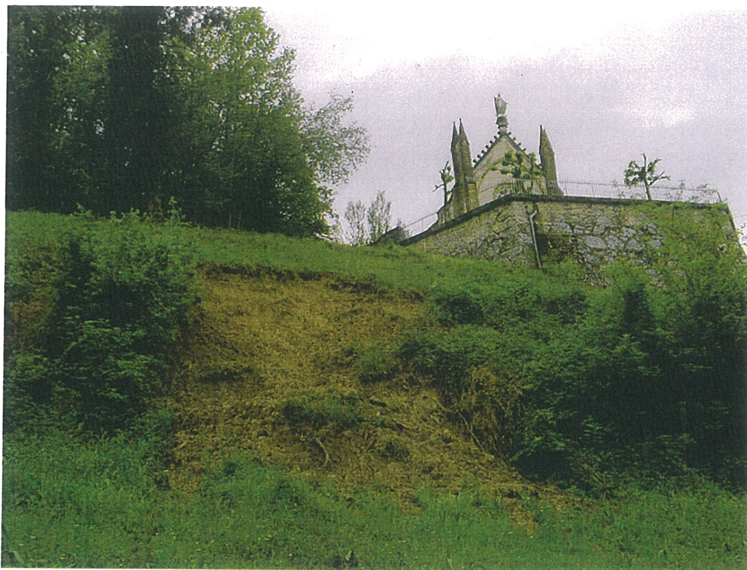
Photo 10 : Glissement de terrain affectant le talus de la chapelle du Puech - 17/05/02 (Cliché RTM 09/31)
