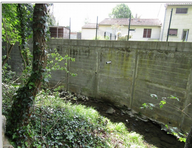
Figure 3.20: confortement de la rive gauche du ruisseau de Lansonne au lieu-dit la Sarraillère ; une déstabilisation de l'ouvrage n'est pas à exclure.
