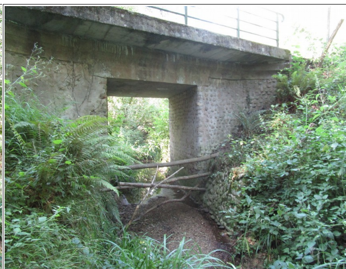
Figure 3.19: pont du chemin de Petit-Paris ; une clôture a été mise en place en travers de l'ouvrage.
