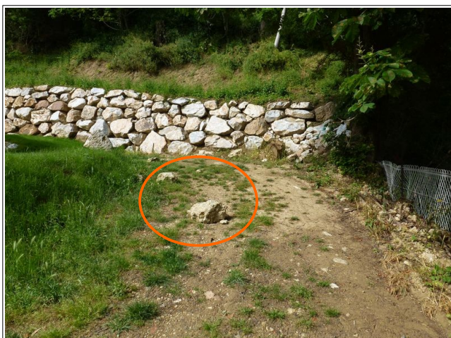
Figure 3.57: chutes de blocs en 2017, on notera le volume des blocs (photo DDT09).
