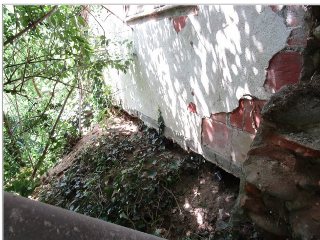
Figure 3.54: maison située au ras de la bordure de la berge et début de découverture des fondations.
