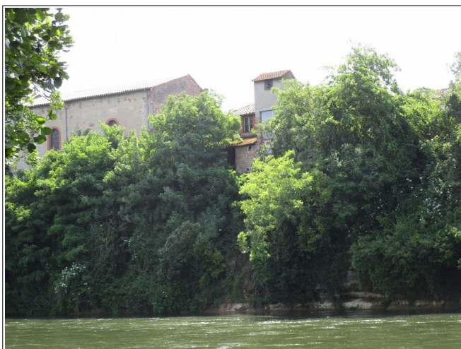
Figure 3.52: rive gauche de l'Ariège soumise à un grave phénomène de régression de berge.
