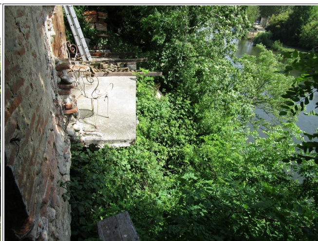
Figure 3.53: vue plongeante de la berge au ras des maisons ; le trottoir repose quasiment dans le vide.
