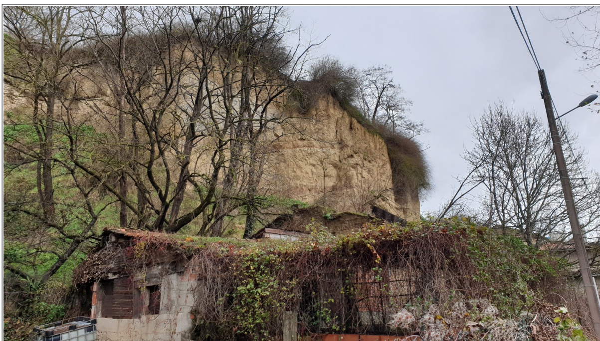
Figure 3.59: aspect général dégradé de la falaise de Sainte-Colombe.
