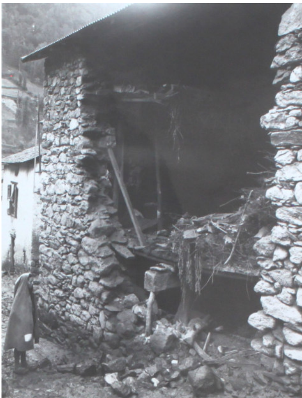
Maison éventrée par l'inondation
