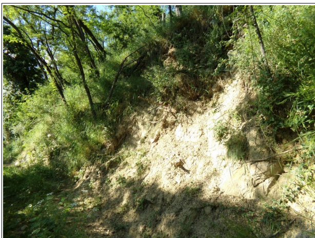
Figure 3.39: exemple de glissement de talus sur un chemin rural à proximité du hameau de Jarnat.
