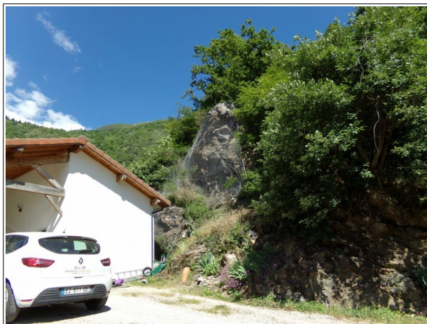
Figure 3.52: filet plaqué contre un talus rocheux pour la protection d'une maison au nord du village d'Amplaing.
