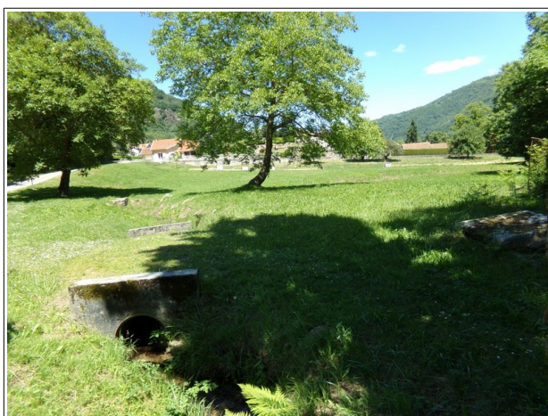
Figure 3.16: ruisseau de Teillet à l'amont immédiat du village d'Amplaing et vue générale de son champ d'inondation potentiel.
