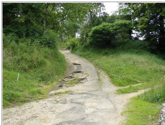
Figure 3.29: chemin rural de Réjau raviné en mai 2018.
