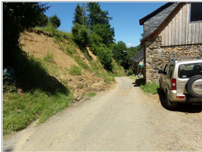
Figure 3.34: glissement du talus amont du chemin reliant les hameaux de Loutrein et de Sanson.
