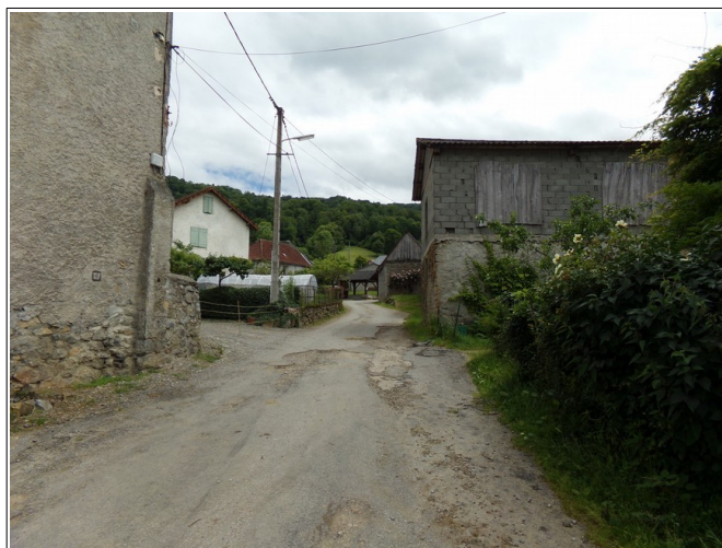
Figure 3.13: route du hameau d'Astien endommagée après un débordement du ruisseau d'Autère.
