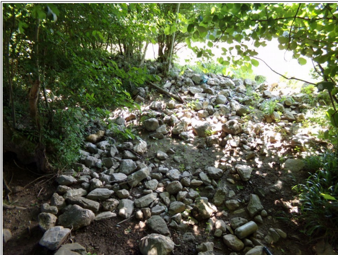
Figure 3.27: brèche dans l'endiguement du ravin de Barrat
