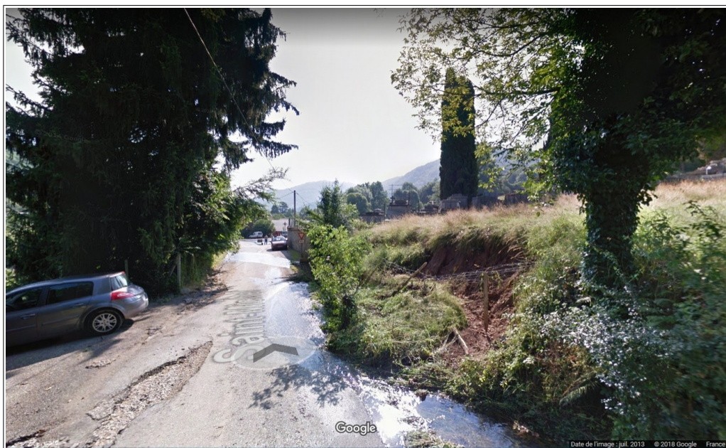
Figure 3.2: à l'entrée du village. Le fossé du chemin de Saint-Michel déborde sur la chaussée suite au glissement du talus de la route (copie d'écran Google Street-View juillet 2013).
