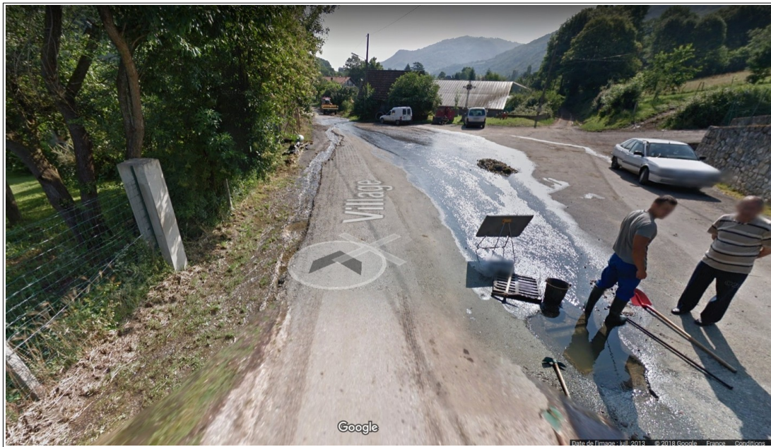
Figure 3.3: refoulement par un regard des écoulements du fossé de la route Saint-Michel au droit du cimetière (copie d'écran Google Street-View juillet 2013). Sur le bord gauche de la chaussée, on distingue également la trace laissée par les débordements.
