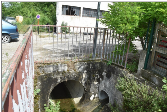
Figure 3.29: ruisseau de Raissac au niveau de la Cité Lakanal. On notera la buse de rejet d'eaux pluviales sur la droite.
