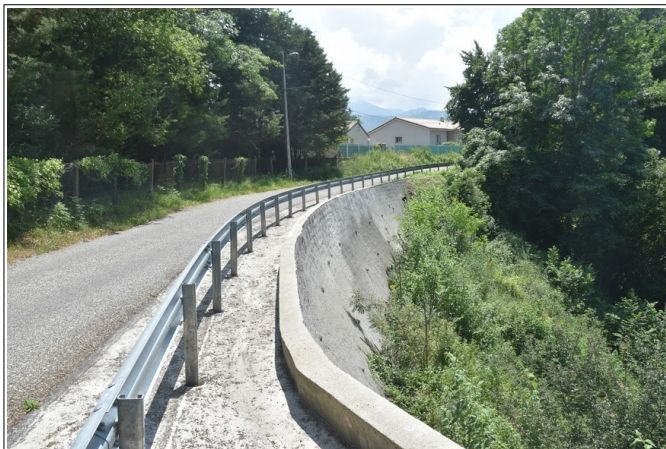
Figure 3.46: Glissement de terrain au droit de la maison de retraite et mur de soutènement confortant la RD210.
