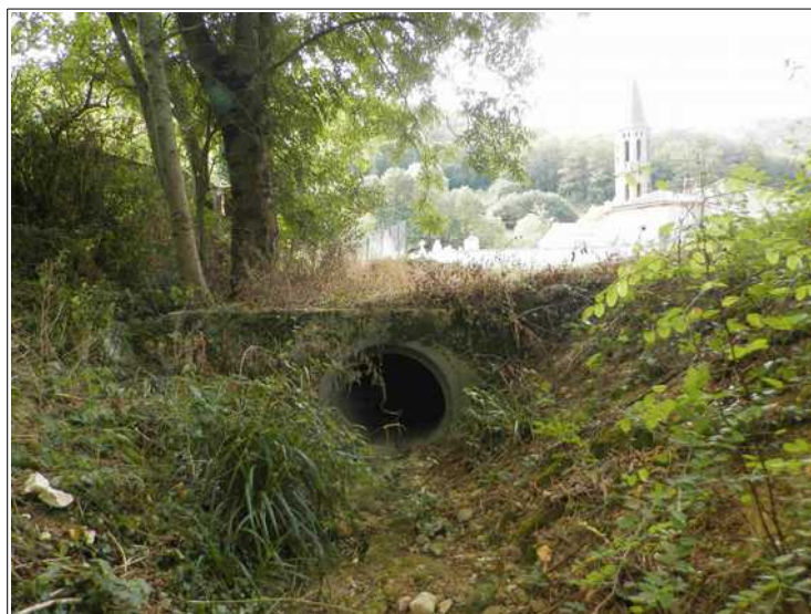
Figure III.8: entrée du busage du ruisseau de Burlan en place dans la traversée du village.
