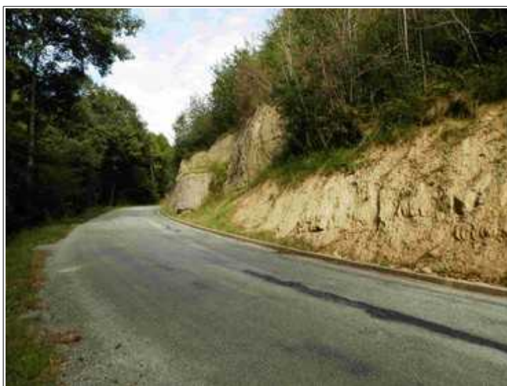
Figure III.15: talus rocheux de la RD13. En arrière plan, on distingue la partie qui a fait l'objet de confortements.
