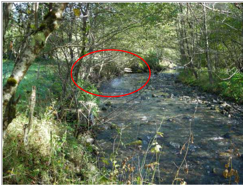
Vue du LEZ à l'amont du hameau d'ESPERRIS, la rivière tend à éroder sa rive gauche (cercle rouge) qui a été confortée à l'aide de poteaux en béton.
