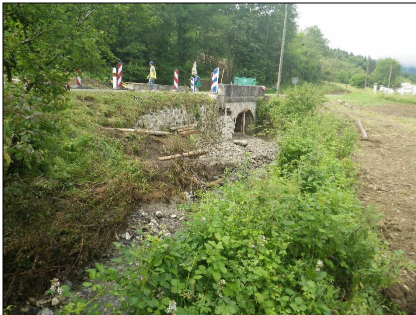
Figure 7 : vue aval du pont de la RD9 sur le ruisseau de Coume Escure (en cours de réparation)
