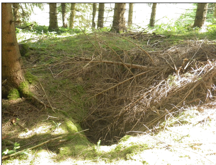
Figure 21 : Fontis localisé dans le même secteur (source : Agerin)
