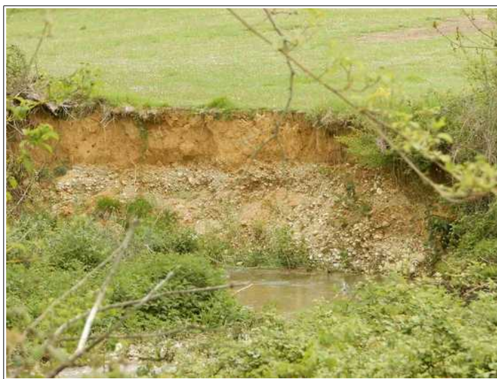
Figure III.1: érosion des berges du Crieu à l'amont immédiat de Saint-Félix-de-Rieutord.
