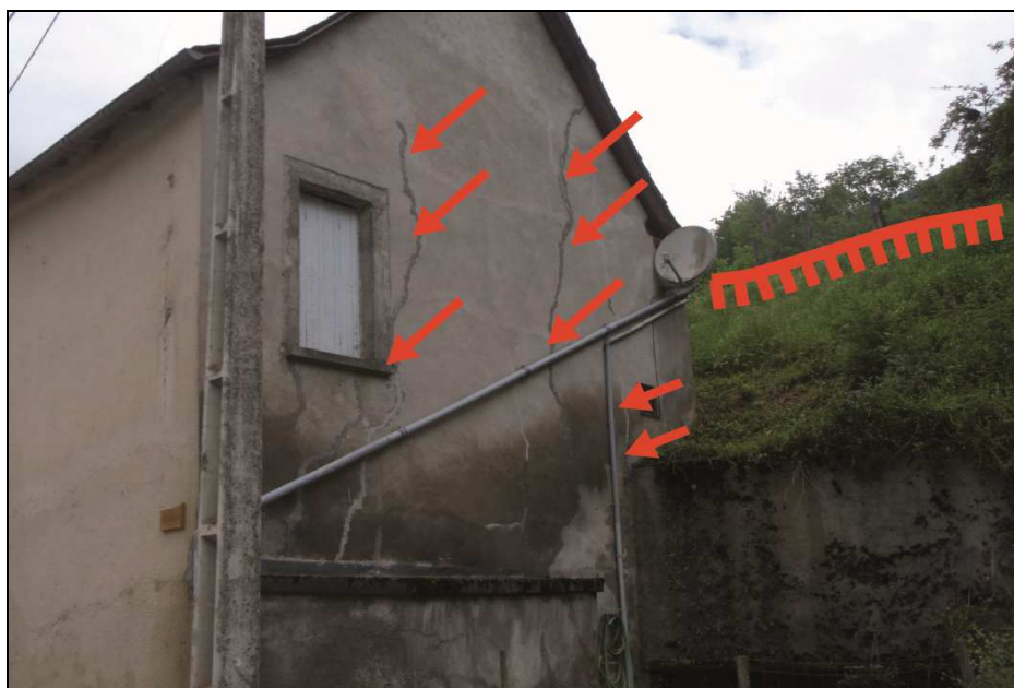
Figure 21: Fissures sur une habitation encastrée dans le pied de versant à Marbre (source: Agerin)
