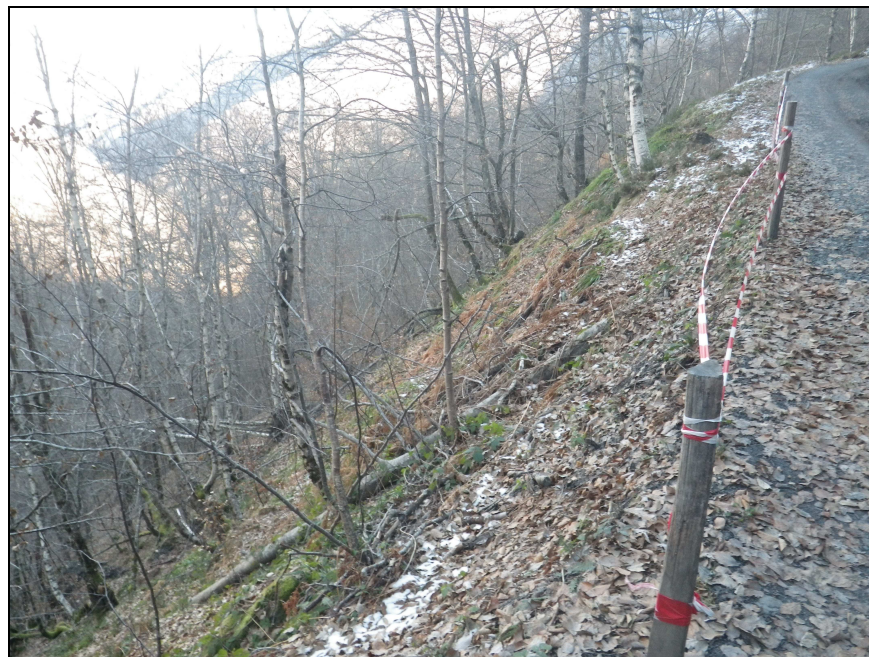
Figure 18: Instabilités et arbres en crosses au niveau de la piste de Pradecals (source: Agerin)
