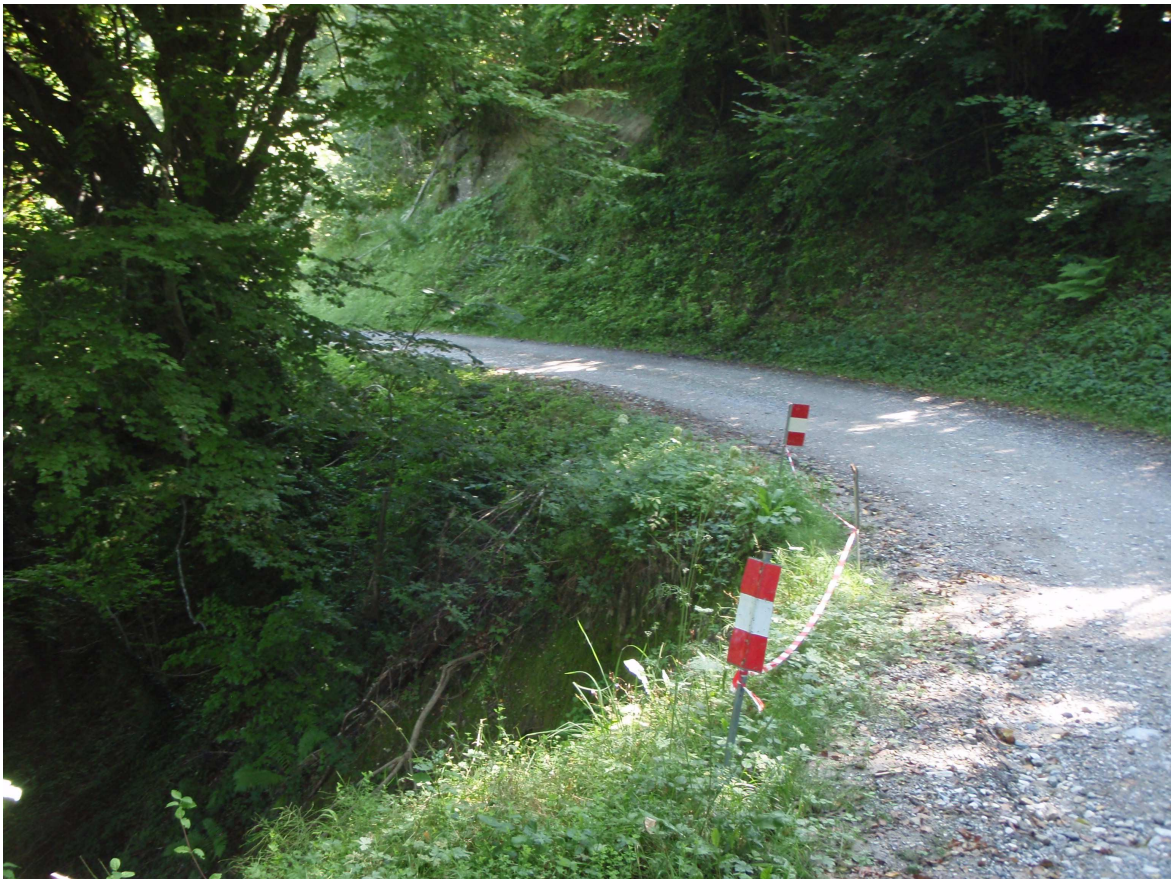
Glissement de berge déstabilisant la route menant au hameau du Pla (Source AGERIN)
