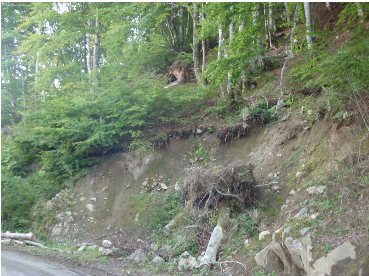
Glissement dans le long de la route forestière du bois de Picou de Géu (Source AGERIN)
