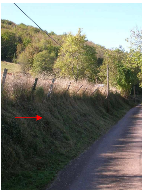
Photographie 6 : Déformations des talus sur la route conduisant au hameau de Seillé (Source : Agerin)
