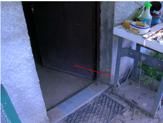
Photographie 9 : Hauteur d'eau atteinte par la crue du 11 juin 2008, à l'Aiguillon (grange de Mr Bloy)
