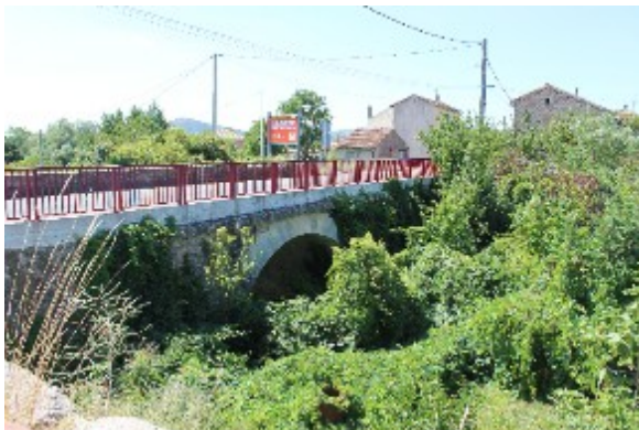
Ouvrage STL07 – Abords du ruisseau encombrés
