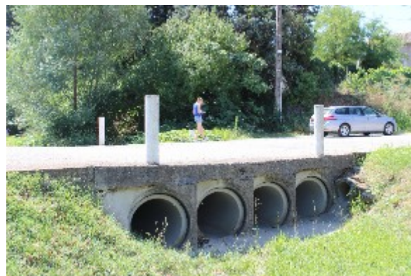
Aval de l'ouvrage STL09 – PHE STL_04 : Déversements sur la route en cas de forts orages
