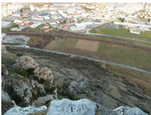
Illustration 15: Route départementale n°86 en aléa fort de chute de blocs
