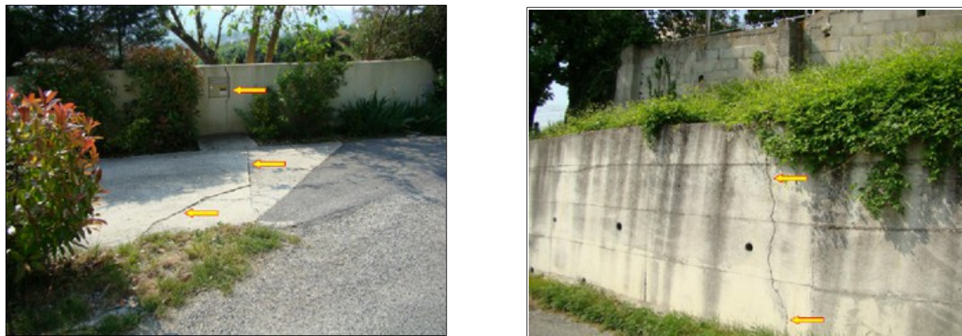
figure 44 : Fissuration d'un mur et d'une rampe bétonnés dans le hameau de Chaumier (en amont du versant)
