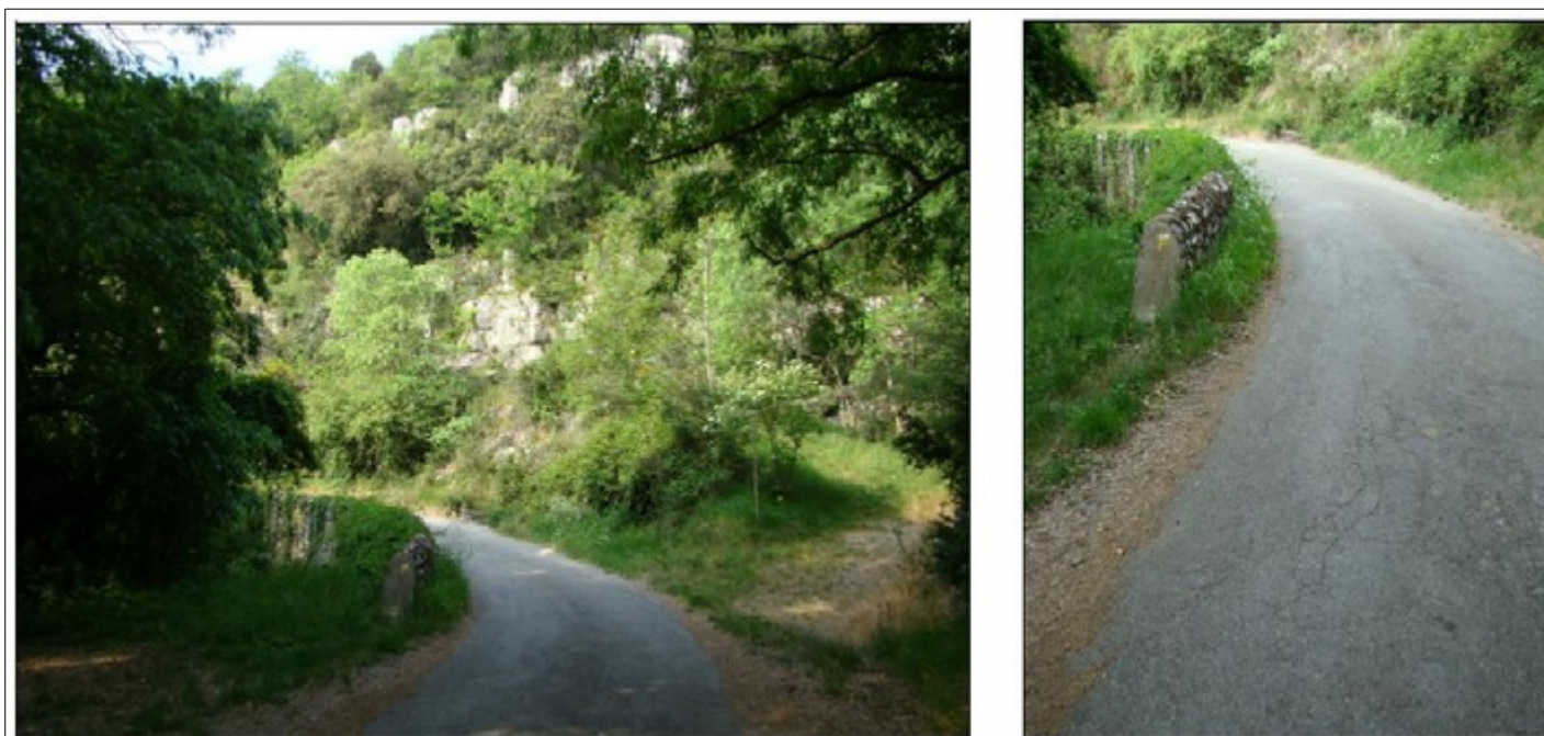
figure 63 : Talweg marqué et fissuration de la chaussée au niveau du hameau des Aliberts
