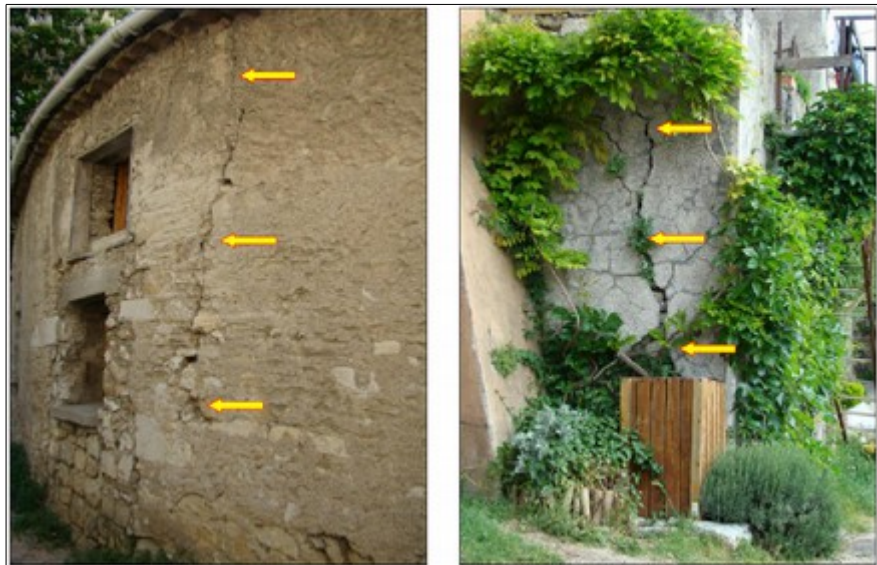
figure 60 : Fissuration importante des bâtiments dans le hameau des Aliberts
