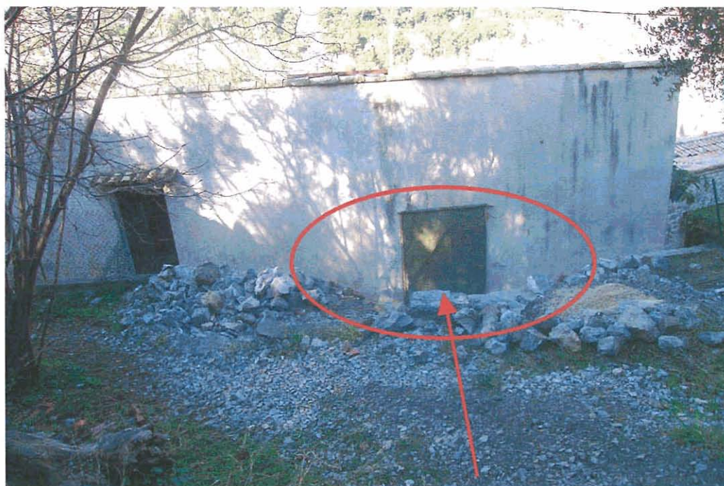
Localisation de l'impact du bloc, calfeutré par une bâche, sur la restanque et le mur amont de la propriété.
