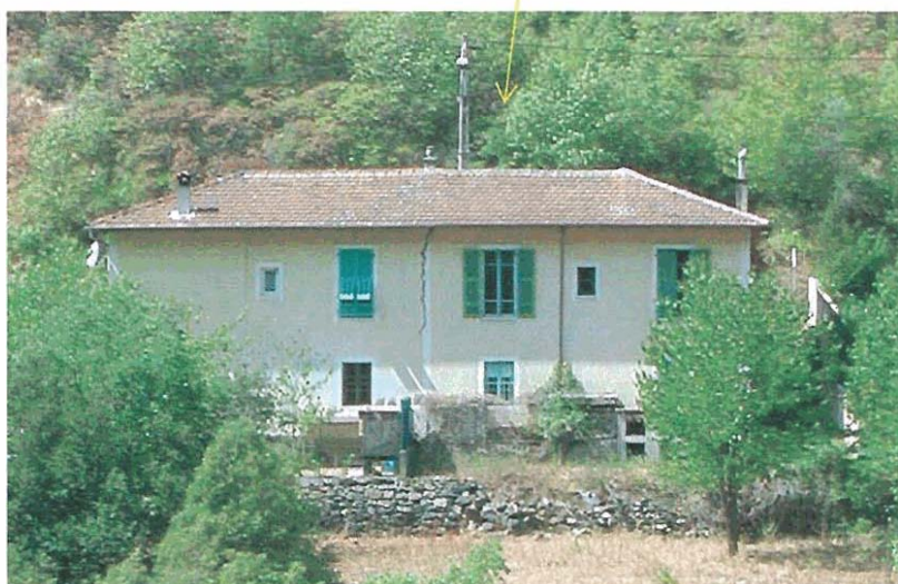
Habitation sous l'emprise d'un glissement bancs sur bancs ; à proximité de la Mairie d'Utelle
