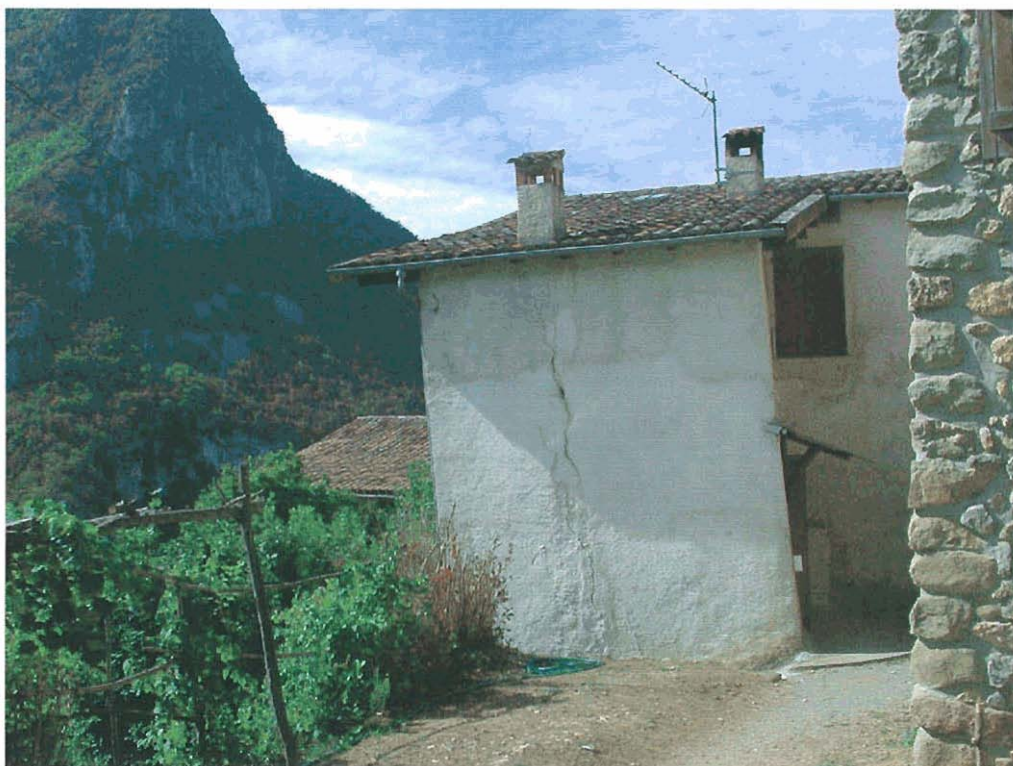
Secteur de « la Ville » : maison affectée par un tassement différentiel.
