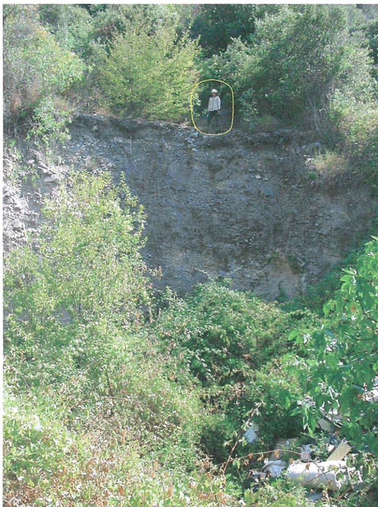
Effondrement au « Collet des Moutons »
