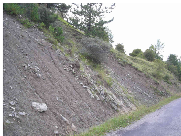
Talus amont de la RD93 à l'aval du village, plusieurs cicatrices témoignent de l'instabilité du terrain .
