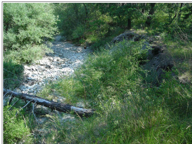
Vue du torrent de Saint-Pancrace à l'aval de la RN94, son lit peu marqué est propice aux débordements.
