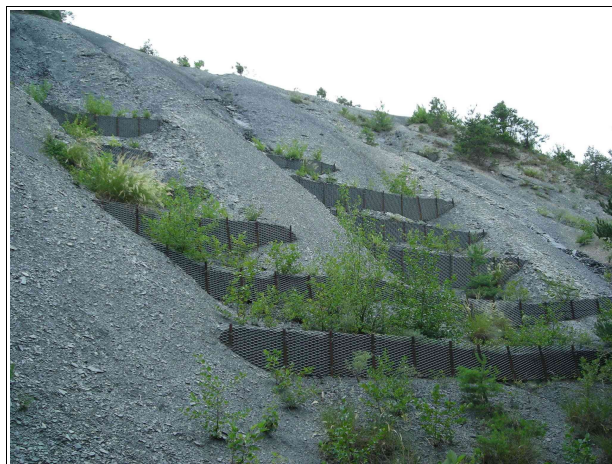
Le versant à l'amont du chemin rural de la Draye est localement équipé de fascines.
