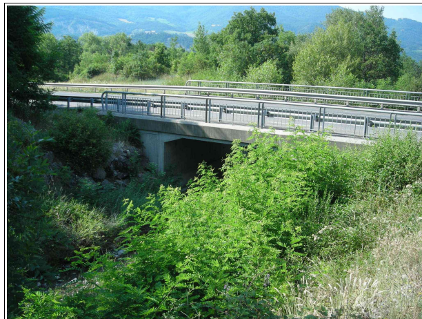
Pont de l'actuelle RN94, en cas de débordement à ce niveau, le torrent se déversera en rive gauche (coté Montgardin) puis empruntera cette route et divaguera sur son cône de déjections.
