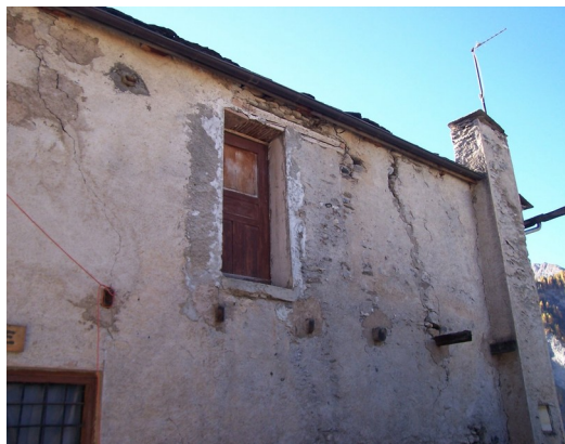
Figure 14: Fissures sur le bâti de Saint-Véran (Alp'Géorisques, 2010).
