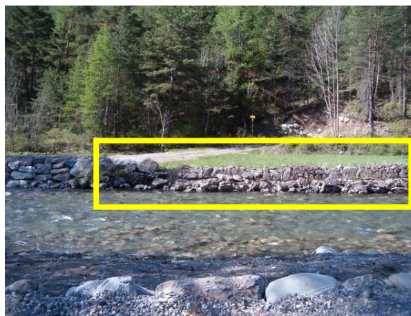
Figure 14 – Faiblesse de la berge RD, 250 en amont des HLL (Alp'Géorisques)
