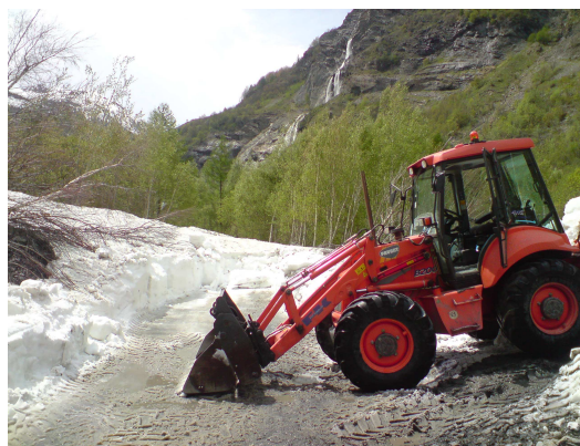
Figure 10 – Enlèvement de l'avalanche au Pont du Laus (Mairie de Freissinières, 2008)
