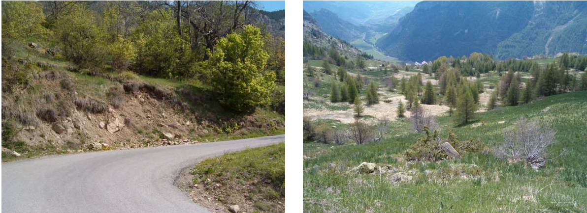
Figure 22 – Signes de glissements entre le Clos des Seigneurs et les Ribes (Alp'Géorisques)
