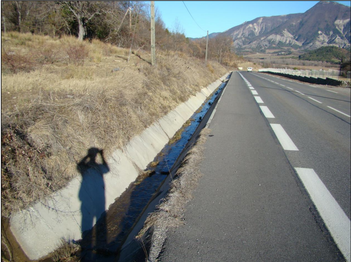
Figure 40 : Glissement dans le secteur de la Baumette, écoulements en pied de talus [Source : IMS RN ]
