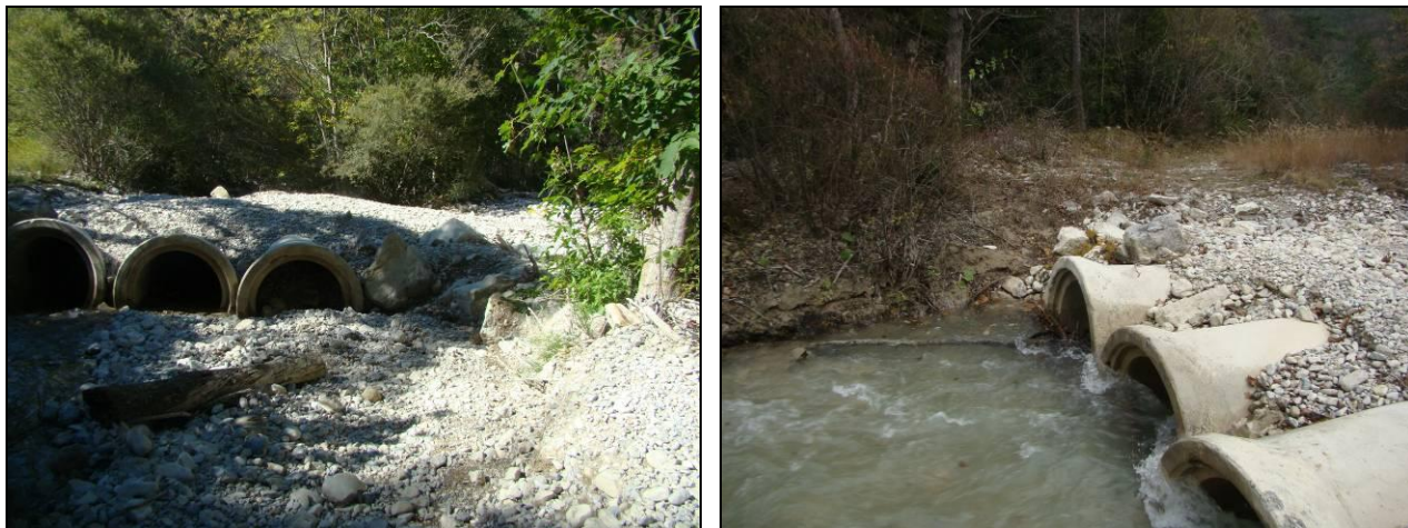
Figure 79 : Pont constitué de 3 buses en amont de l'embouchure avec le Grand Buëch, en septembre à gauche, en novembre à droite. [Source : IMS RN ]
