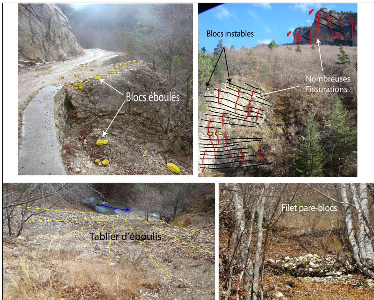
Figure 48 : Éboulements / chutes de blocs dans le secteur de la forêt de Durbon [Source : IMS RN ]
