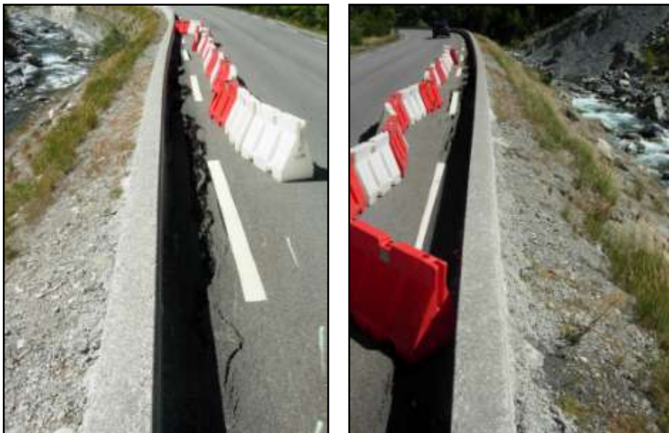
Figure 70 : Dégâts sur la RD 902 (et le talus conforté), le long du Guil, suite à des érosions de berges [Source : IMS RN ]
