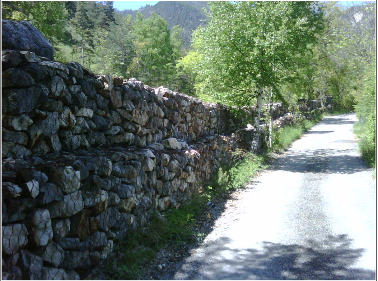
Digue de gabions en mauvais état en rive gauche du Gros-Riou à Prelles.
