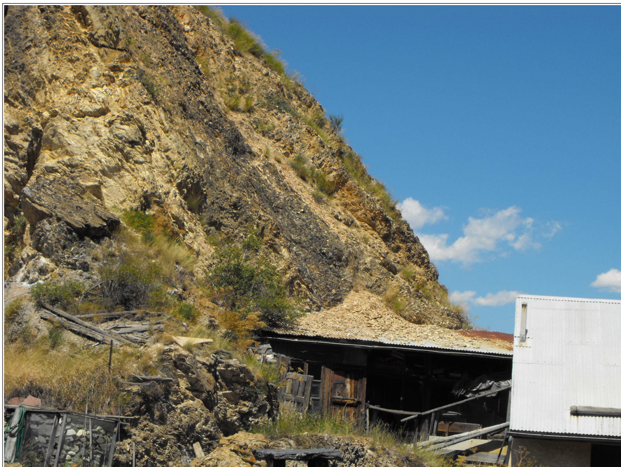
Intense délitage et nombreuses chutes de Pierres à Queyrières.
