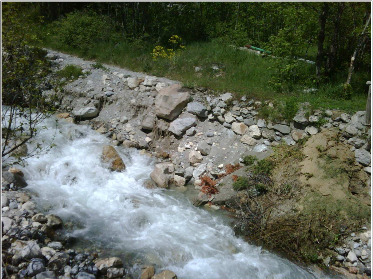
Protections de berge dégradées, dépôts torrentiels et décharge sauvage sur le Gros-Riou à Prelles.
