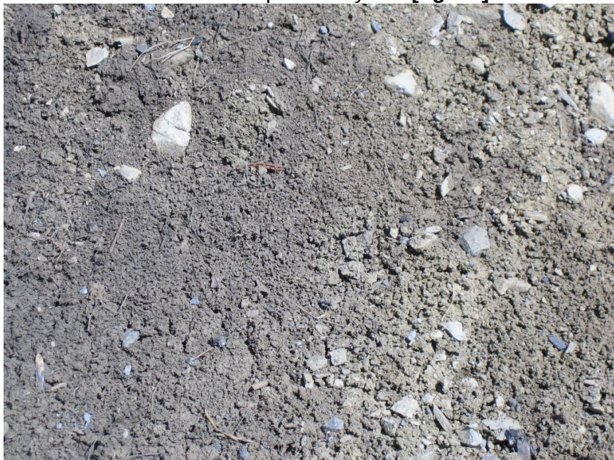
Figure 10 : Formation des marnes à Globigérines très favorable aux glissements de terrain [Source : IMS RN ]
