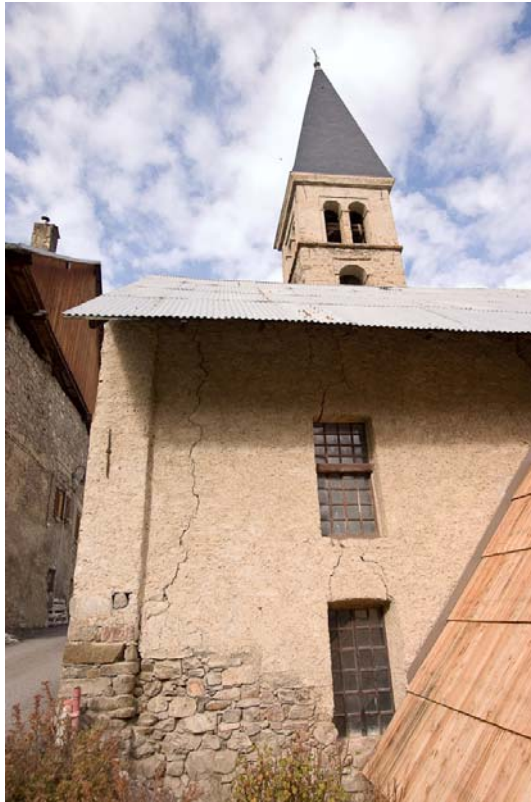
Des fissures semblent indiquer des mouvements lents anciens au niveau de l'église, novembre 2008
