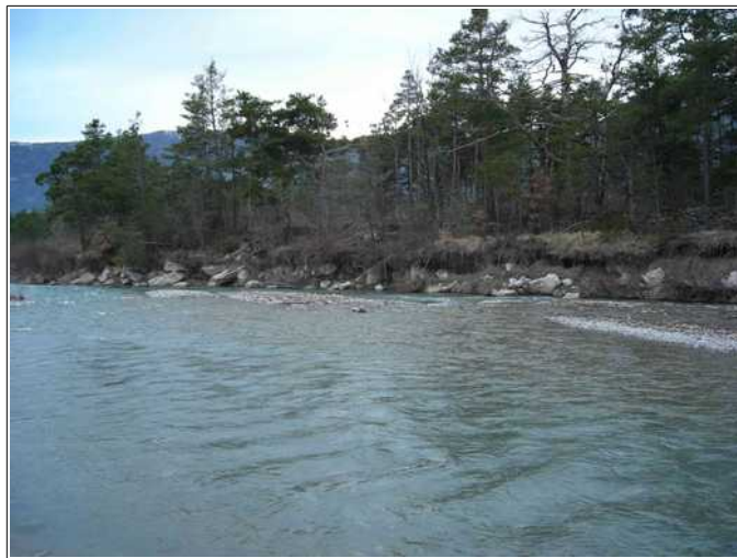
Erosion de la rive droite du Buëch au droit de la Ferme Ricou.
