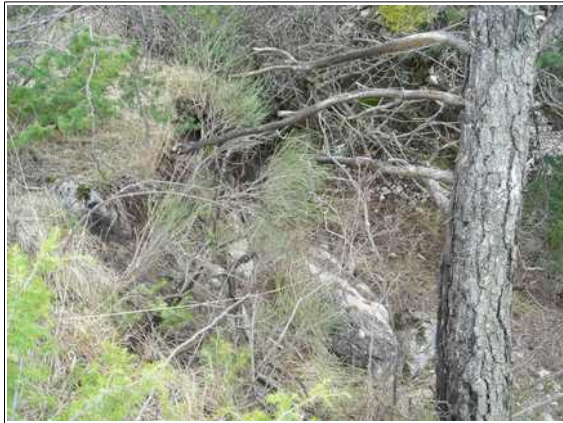
Digue ancienne (dans le prolongement de la RD937), on notera l'importante végétation (arbres et broussailles). De plus l'ouvrage présente un aspect très vétuste.
