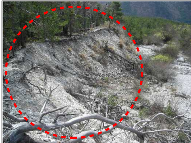
Brèche importante dans la digue rive gauche de la Sigouste (aval de la RD9337a).
