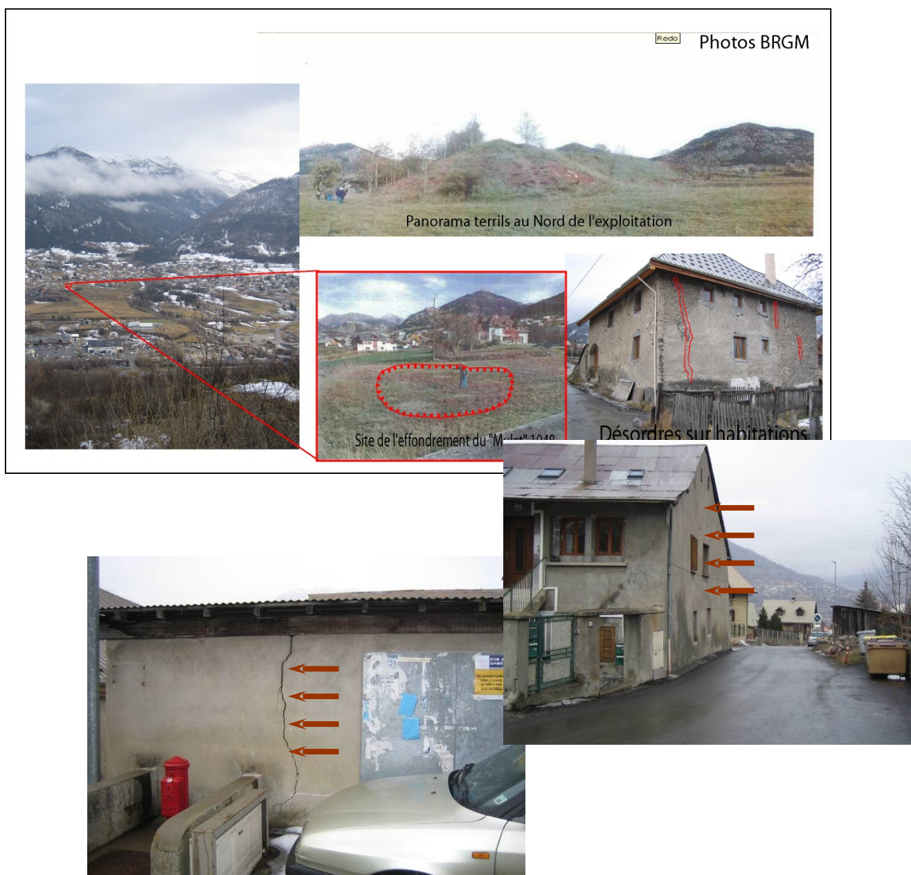
Figure 25 : Zone d'affaissement et désordres observables au niveau des zones d'effondrements anciens de la concession de La Tour.
