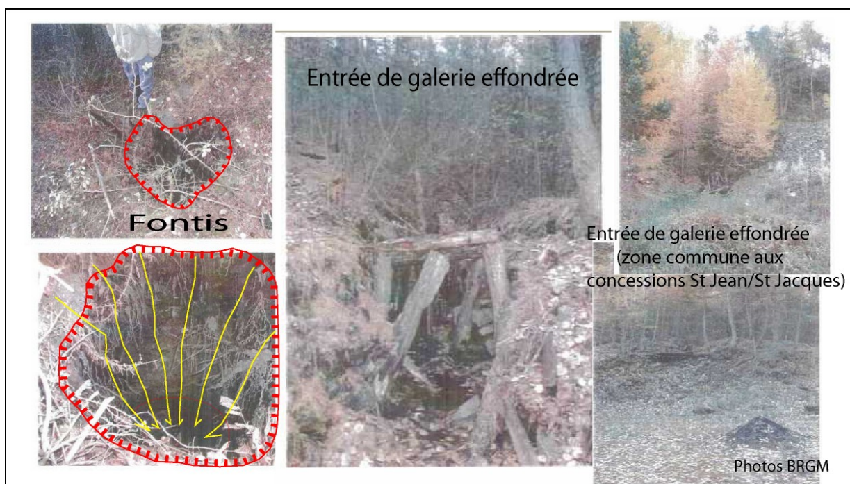
Figure 24 : Entrée de galerie effondrée- Fontis ouvert sur galeries-(Zone commune aux concessions de Saint-Jacques).
