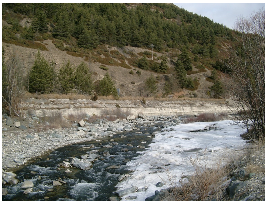
Photo 10 : digue rive droite du Guil en aval du pont de la RD 5 : mauvais état général de l'ouvrage.
