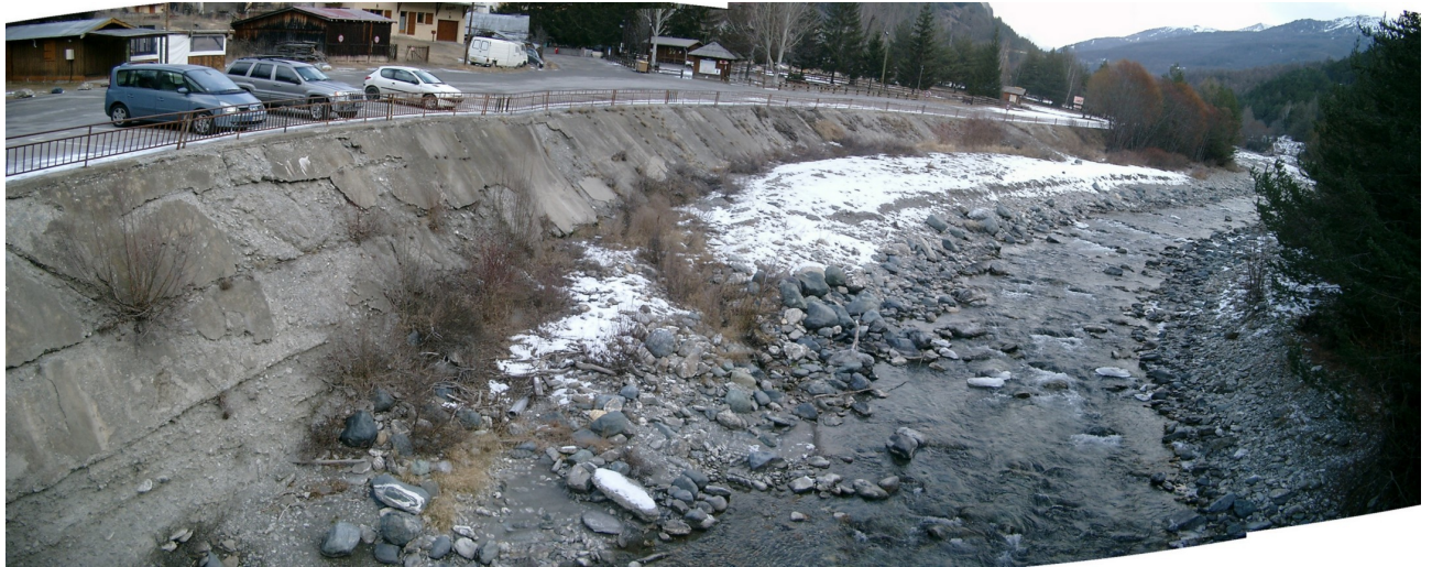
Photo 11 : le Guil canalisé en amont du pont de château Queyras : la digue est dans un état très dégradé.
