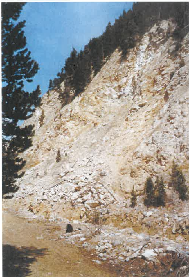
Photo 5.25 - Chute de pierres en rive gauche du torrent du Roubion.
