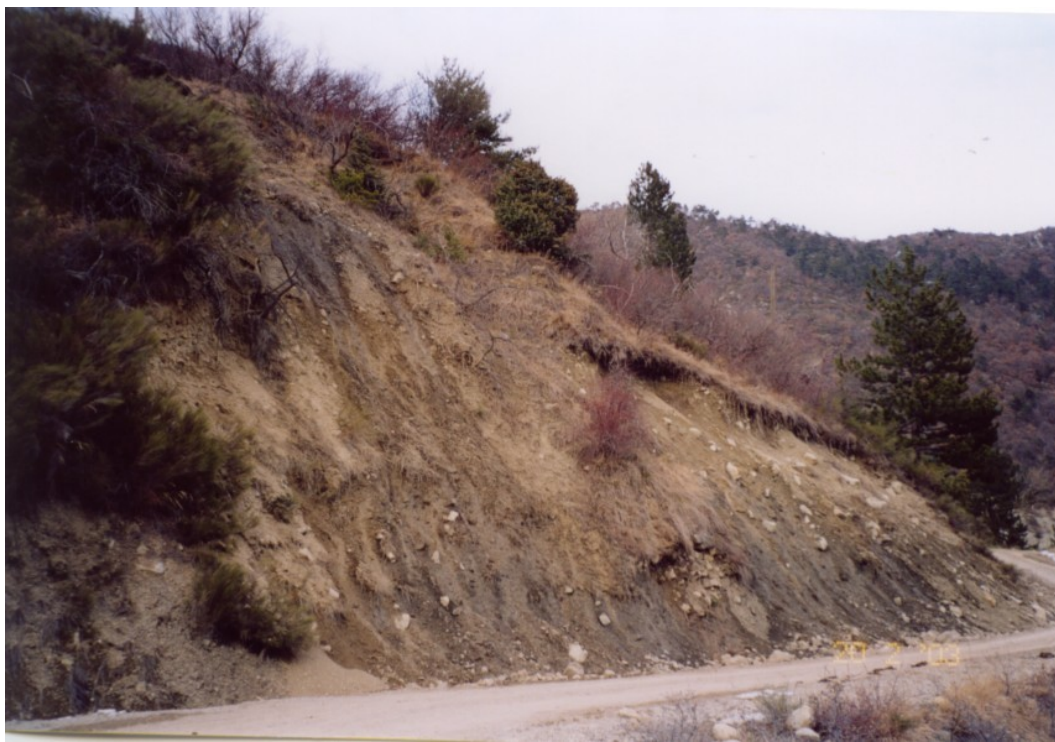
Photo 11 – Glissement de terrain sur le talus de la route de CHATEAUVIEUX
