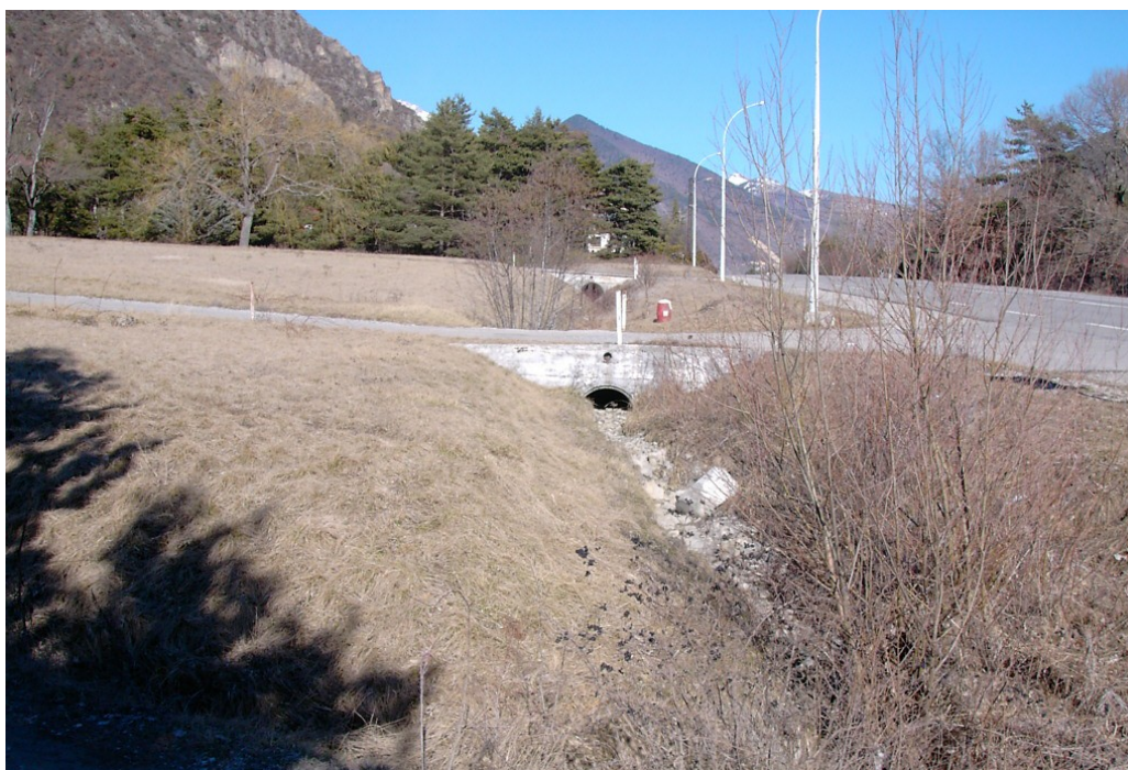
Photo 8 – Passage busé partiellement bouché sur le torrent de COMBE LA BOUGE
