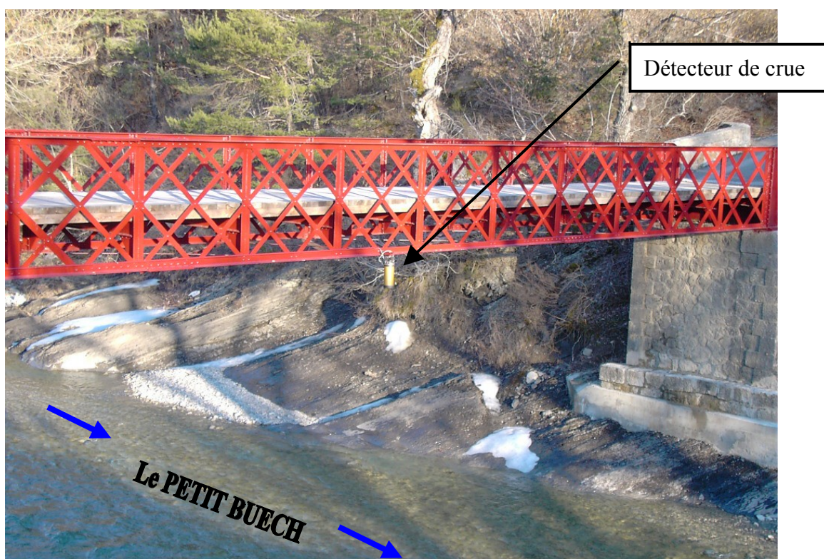
Photo 19 – Détecteur de crue sous le pont de la MORELLE
