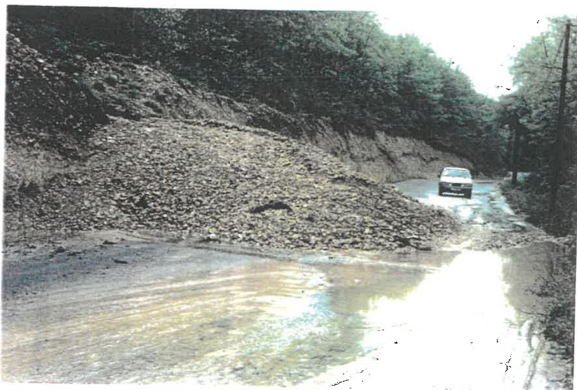
La route d'Allemagne-en-Provence à Riez partiellement obstruée par les matériaux provenant d'un ravin. (Photo M. Mensang)
