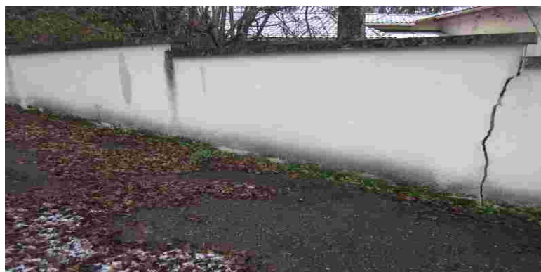
fractures au niveau du mur de clôture.
