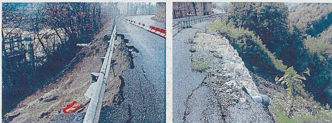
Figure 9 : Glissement de terrain sur la RD 72a et confortement en enrochement.
