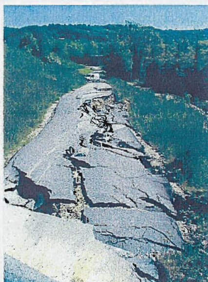
Figure 4 : Glissement de la cité de la Bornière. Photos prises en mars et mai 2001. Source : Services Techniques de la Mairie d'Injoux-Génissiat.
