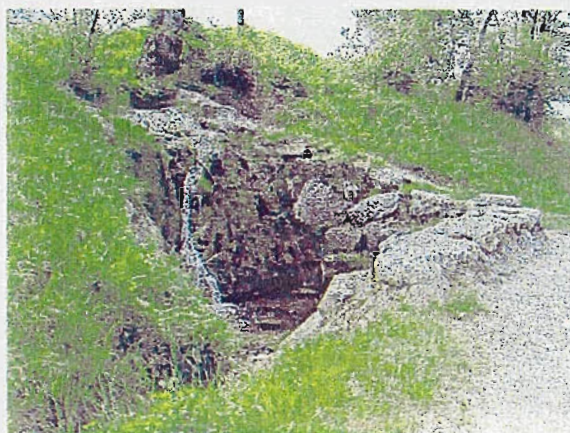
Figure 13 : Avaloir aménagé dans le prolongement du fossé qui borde le Chemin rural de la Montagne.
