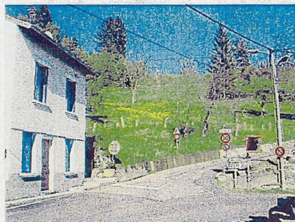
Figure 10 : Venues d'eau dans le talus amont de la route communale et vue sur des prés instables.
