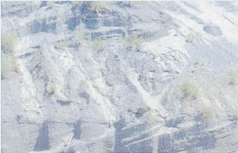
Fig.6 Ravinement au niveau de la carrière du "Crêt des Marches
