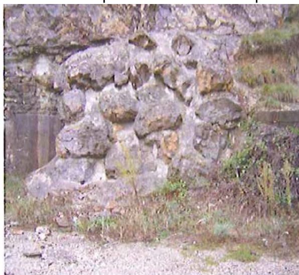
Photo 2 : Constat de la fermeture de l'entrée de Chassiers (janvier 2009)
