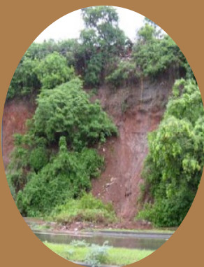
Glissement survenu à Passamainty sur la RN1 en 2008 (source : BRGM)
