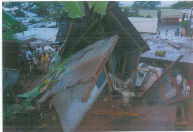
Banga enseveli, quartier M'Gombani Bandraboua
