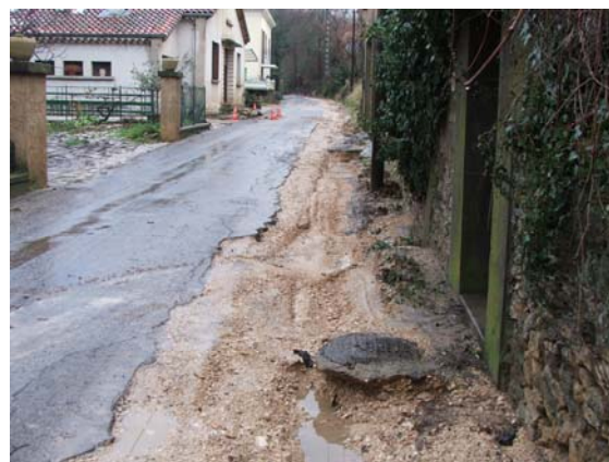
Dégât des eaux décembre 2008 (Source : Mairie d'Apt)
