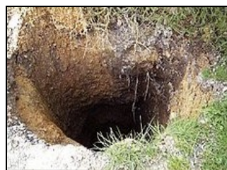
Mouvement de terrain (cavités souterraines)
