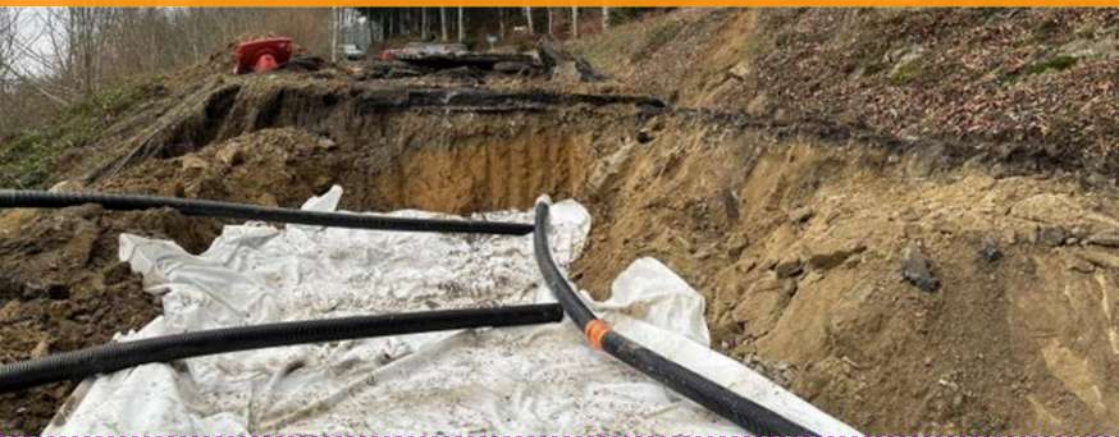
Effondrement de la chaussée sur la route des Voirons (D50), le 13 décembre 2023
