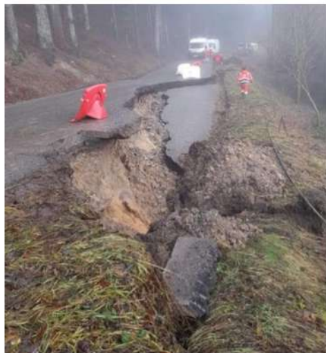
Effondrement d'une portion de la chaussée de la route des Voirons (D50)
