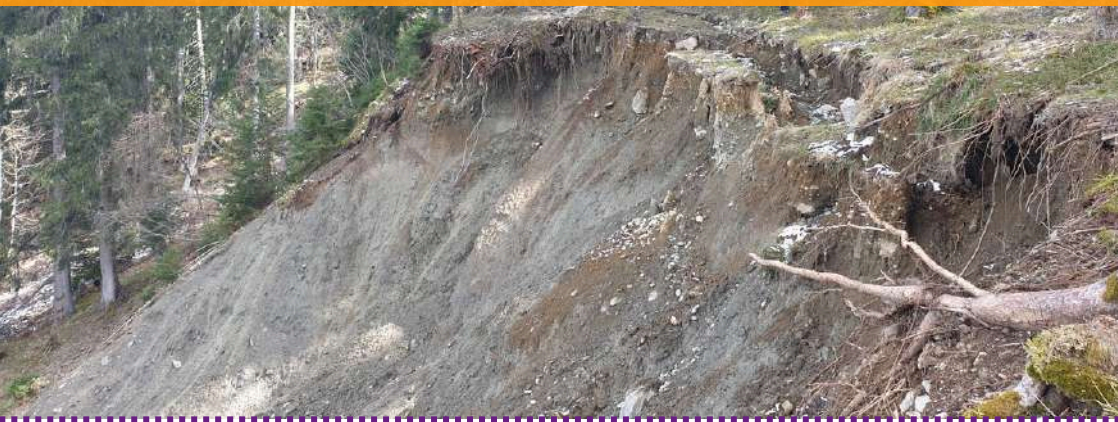
Glissement de terrain de l'Hermettaz (Notre-Dame-des-Millières) mars 2024
