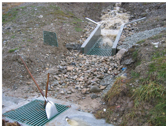
Ruisseau des Trembles La Croix de Fer La grille évite les transports solides
