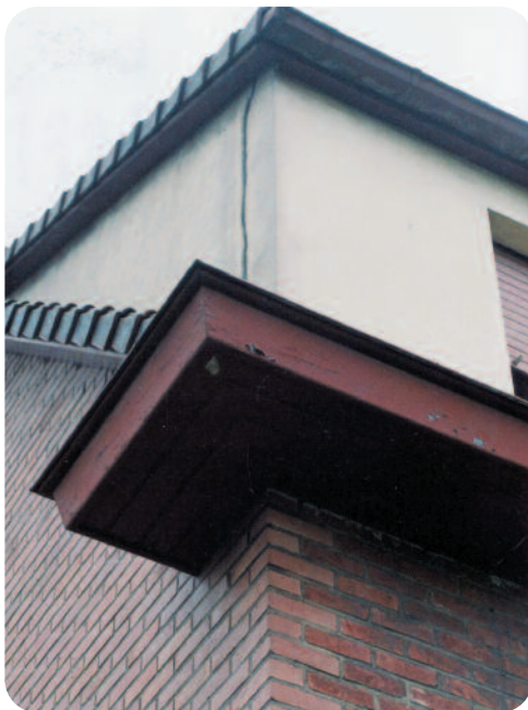
Fissure sur le pignon d'un pavillon suite à un mouvement de terrain.
