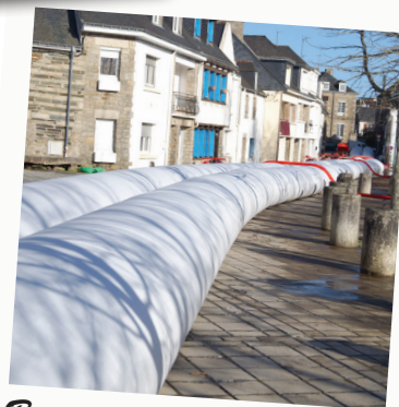
Barrage flottant rue de la Fontaine
